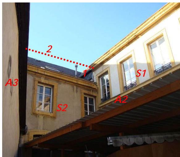
Dans la cour, raccord des bâtiments S1 et S2 (1) et niveau proposé de la surélévation de S2 (2)
